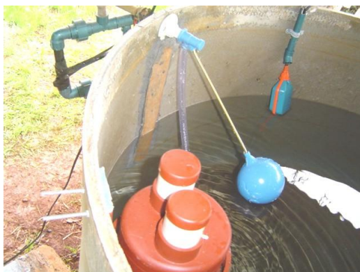
Foto 8 – Detalhe da captação de água e posterior tratamento
